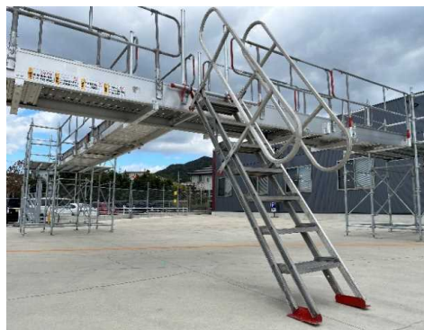
昇降階段設置例
